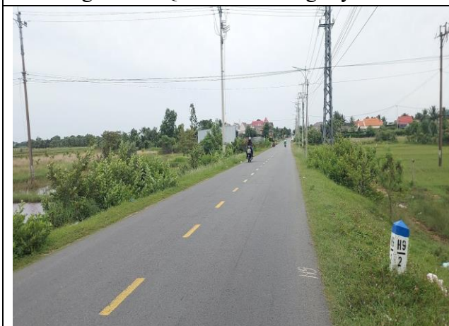
Mặt đường hiện trạng tại Km2+900/ĐT652B
